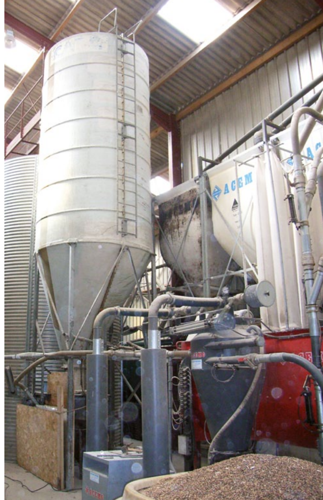
Stockage pour les matières premières et l'aliment.
