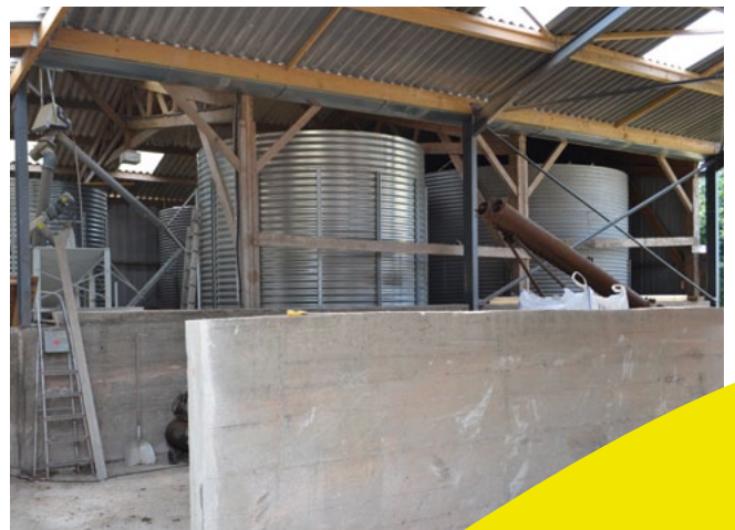
Système de stockage des matières premières
